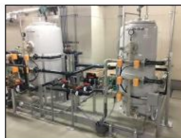
紀の川市 井水ろ過装置
