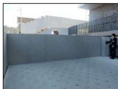
兵庫県洲本市 津波対策バリケード
