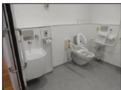
新宮市 障がい者用トイレ
