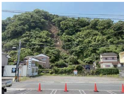
宮山北側法面の土砂崩れ（2021）
