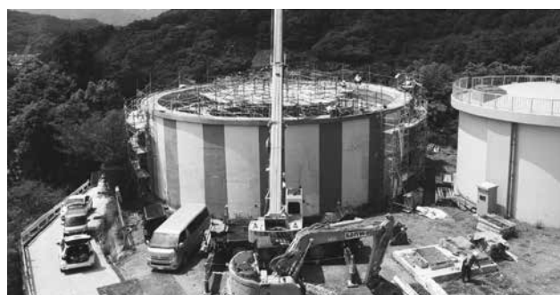
第2配水池（彦の内）
