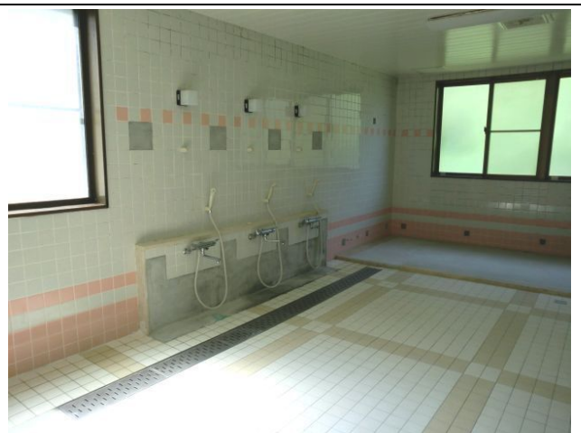
シャワー室の様子
