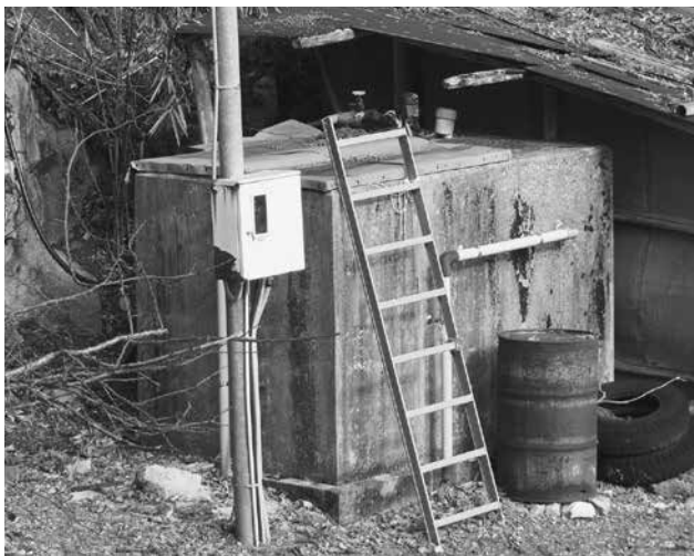
八戸地区飲用水供給施設
