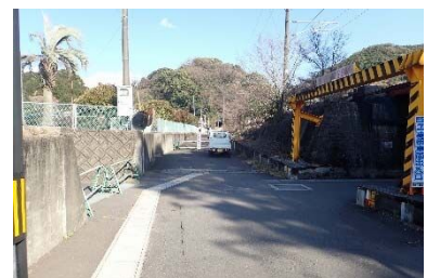
福地区ポンプ設置箇所
