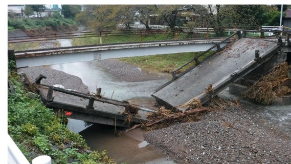
▲平成29年台風第18号の際、市役所前のグラウンドに浮かぶ自動車(写真上)。崩落した上青江地区の赤木橋(写真下)。
