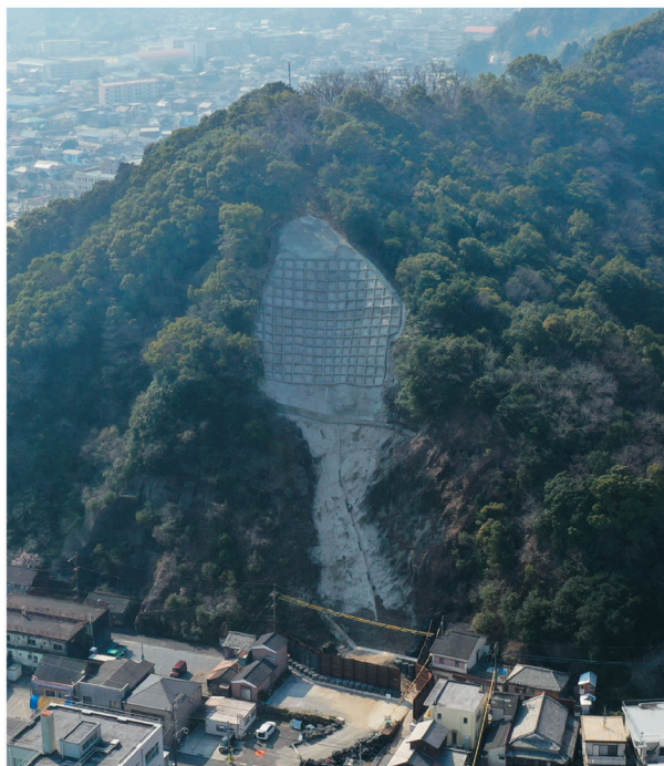
▲令和3年6月24日に崩落した宮山北側斜面。写真は現在の修復した様子。
